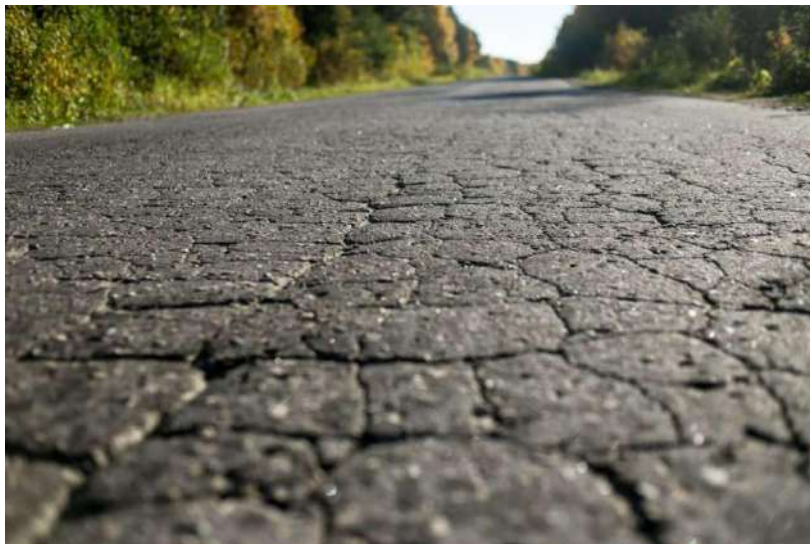
Εικόνα 3.4: Ρωγμές λόγω κόπωσης ασφαλτικών στρώσεων
