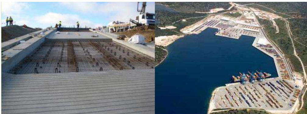
Εικόνα 2.5 Δύσκαμπα οδοστρώματα σε λιμενικά έργα
