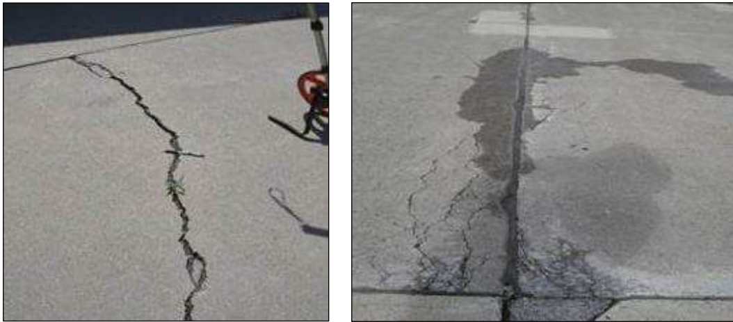
Εικόνα 3.9 Επιφάνειες δύσκαμπτων οδοστρωμάτων που εμφανίζουν ρηγματώσεις-Παράγοντας C του δείκτη PSI
