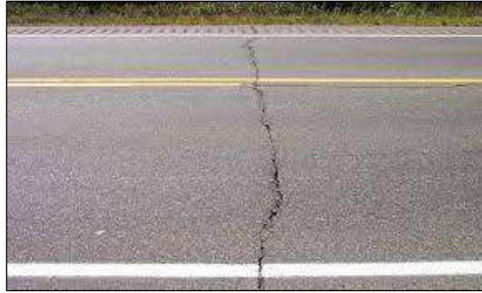
Εικόνα 2.27 Παράδειγμα εγκάρσιας ρηγμάτωσης σε δύσκαμπτο οδόστρωμα
