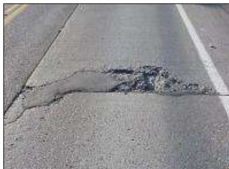
Εικόνα 2.32 Παράδειγμα αποφλοίωσης σκυροδέματος σε δύσκαμπτο οδόστρωμα
