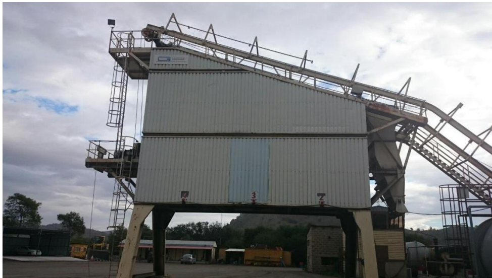
Εικόνα 2.30: Σιλό Αποθήκευση ασφαλτομίγματος (από προσωπικό αρχείο)
