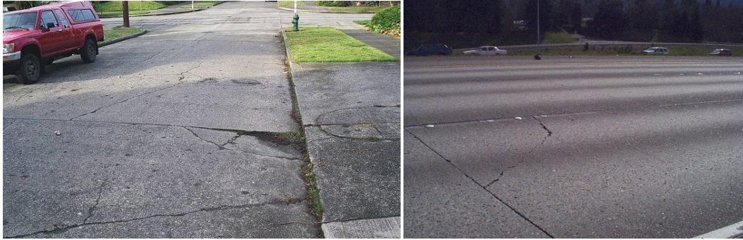
Εικόνα 3.5:Ρηγμάτωση Άκρου Πλάκας Σκυροδέματος (Gerges, 2009)
