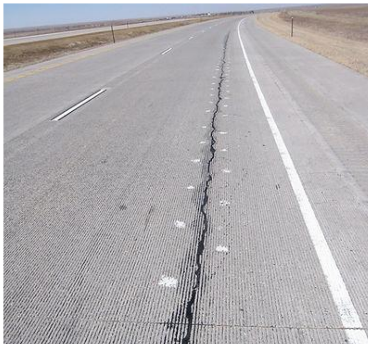
Εικόνα 3.6: Κατά Μήκος Ρηγματώσεις https://www.igqa.net/low-severity-longitudinal-cracks-joints
