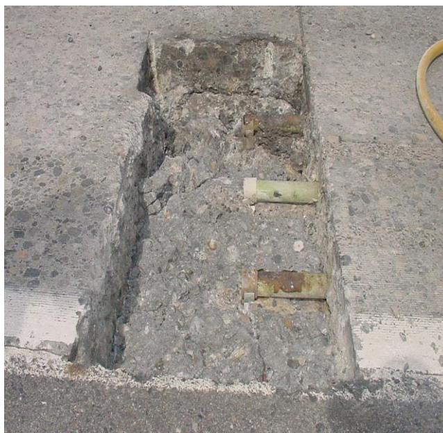
Εικόνα 3.12: Θραύση στα Χείλη Αρμού-Διάβρωση Ράβδου (Gerges, 2009)
