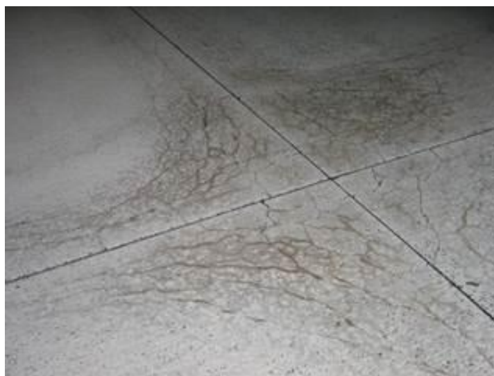
Εικόνα 3.8: Ρωγμές Τύπου "D"
